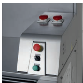
Deux prises électriques triphasées Permet la connexion d'une façonneuse et d'une diviseuse.
