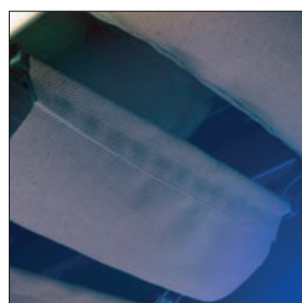
Keimtötende UV-Lampe Zur Sterilisation des Zwischengärbereichs.
